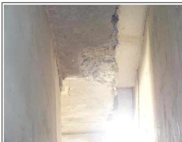
산성교(상주) S1 바닥판하면 콘크리트 파손
