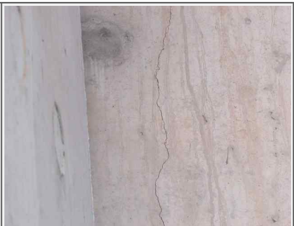
산성교(영천) A1 홍벽 균열 (0.3mm)
