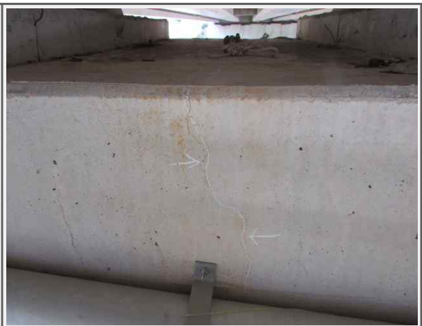
산성교(영천) P1 코핑부 균열 (0.2mm)
