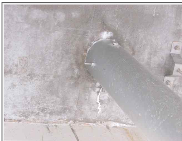
산성교(영천) S2 바닥판하면 균열부백태
