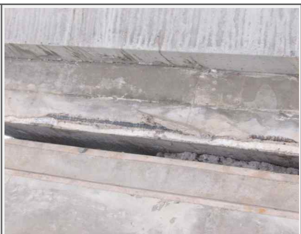
산성교(상주) S4 바닥판하면 철근노출
