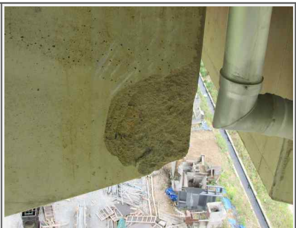
산성교(영천) P5 코핑부 콘크리트 파손
