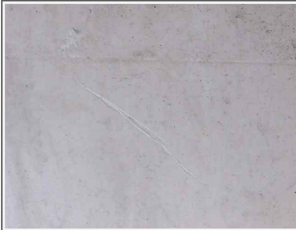
산성교(상주) P1 코핑부 균열 (0.3mm)
