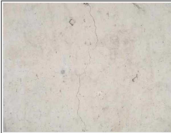
산성교(상주) A1 홍벽 균열 (0.2mm)
