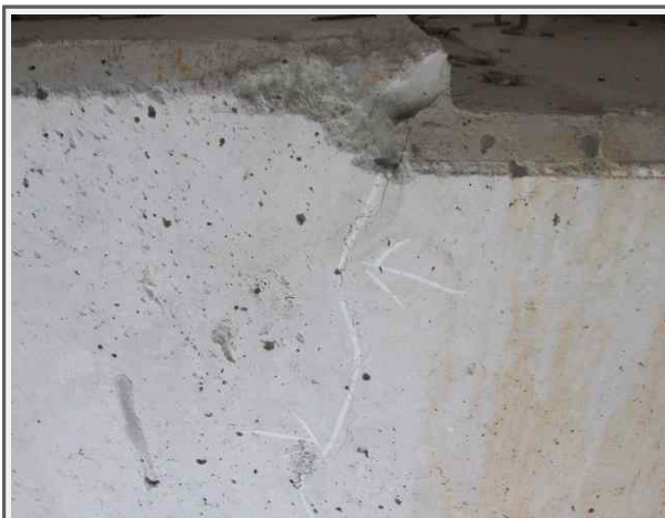
산성교(영천) P5 코핑부 균열 (0.3mm)
