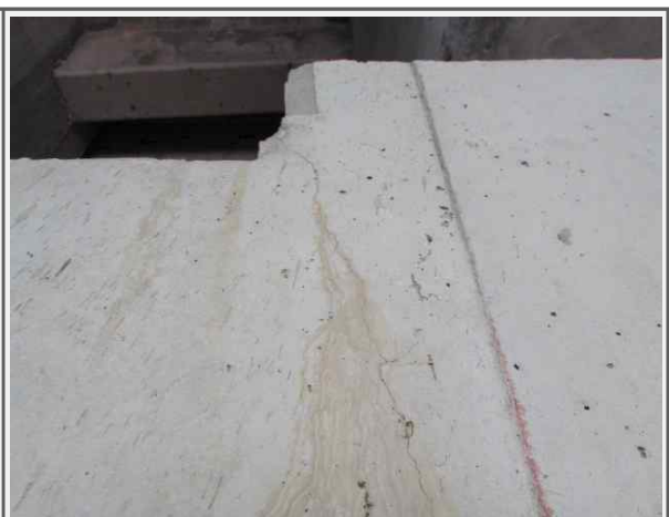
산성교(영천) A2 벽체 균열 (0.2mm)
