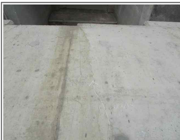
산성교(영천) A1 벽체 균열 (0.2mm)
