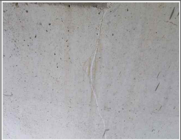
산성교(상주) P6 코핑부 균열 (0.3mm)
