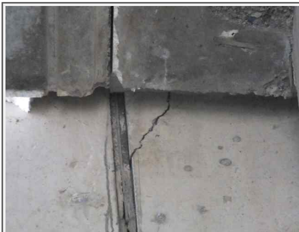
산성교(상주) A1 홍벽 콘크리트 파손
