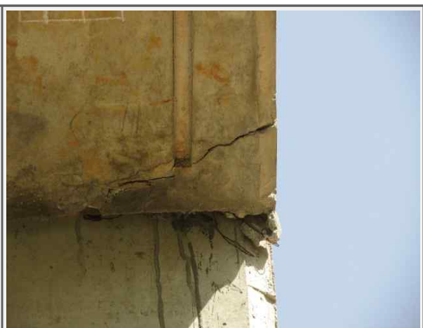
산성교(영천) S7 바닥판하면 콘크리트 파손
