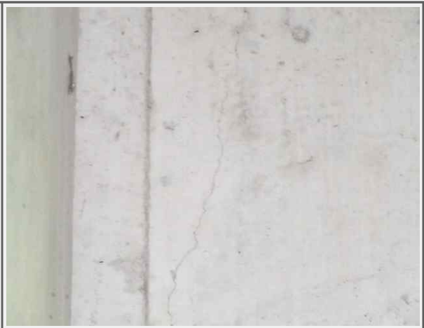
산성교(상주) A2 홍벽 균열 (0.3mm)
